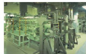
1,000KWクラス ガスエンジン発電設備
